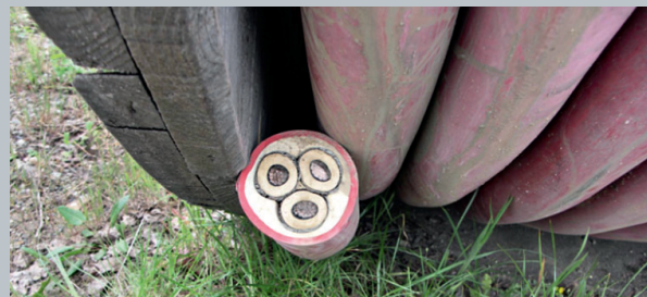
30 kV-Hochspannungskabel aus Kupfer 3 x 120 mm 2 und 3 x 70 mm 2
